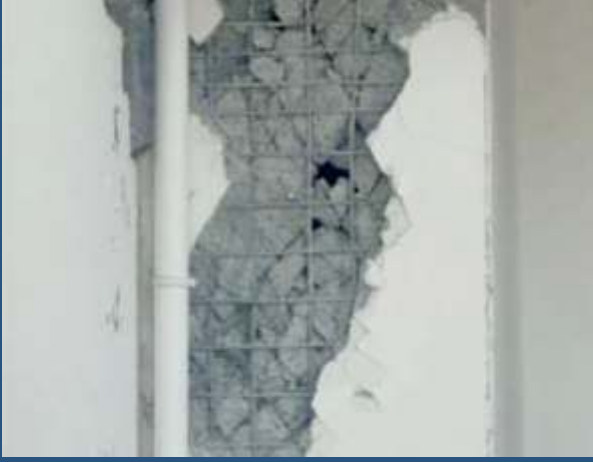
Yeterli dayanıma sahip olmayan beton
